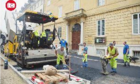
Après 15 mois de travaux, la chaussée sera bientôt ouverte à la circulation. Les derniers travaux de finition, plus fins, ont été réalisés par les équipes de l'ingénieur communal.
